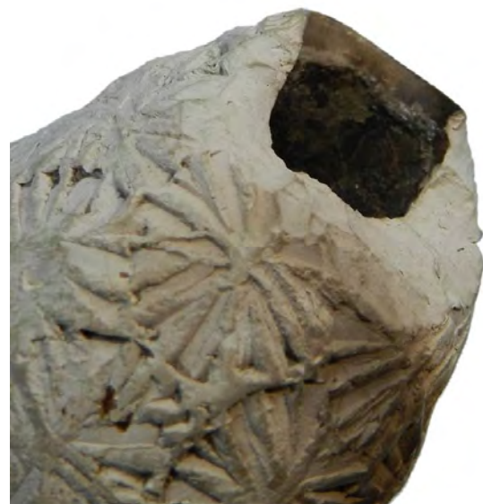
Afb. 5. Roetaanslag in de ketel en op het keteloppervlak.
